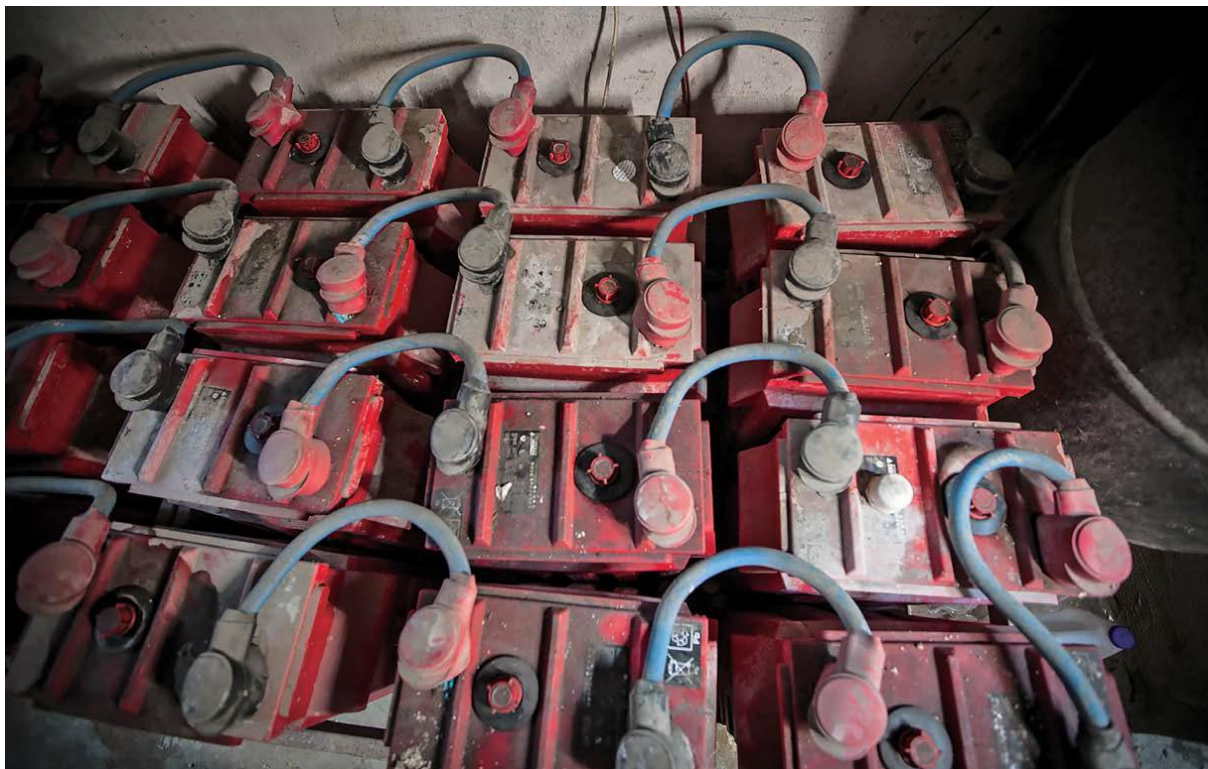
Figure 13 : Un parc batterie qui aurait bien besoin d'attention
