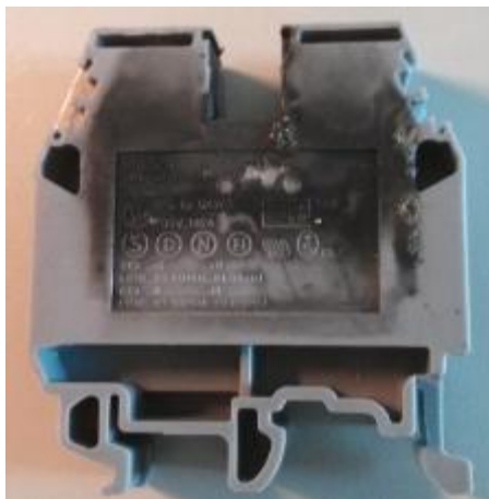
Figure 7 : Une borne marquée par une défaillance
