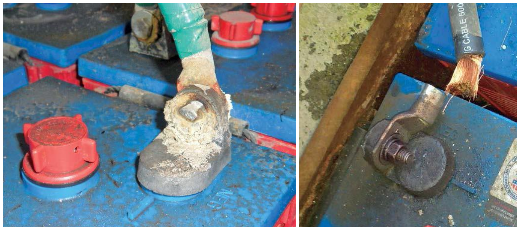
Figure 15 : Terminal en mauvais état
