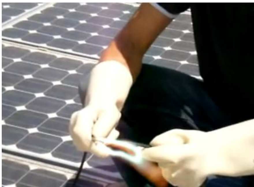
Figure 2 : Arc électrique réalisé sur des modules solaires
