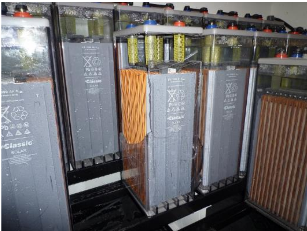
Figure 1 : Explosion d'un élément de batteries suite à un nettoyage avec un chiffon en polyester
