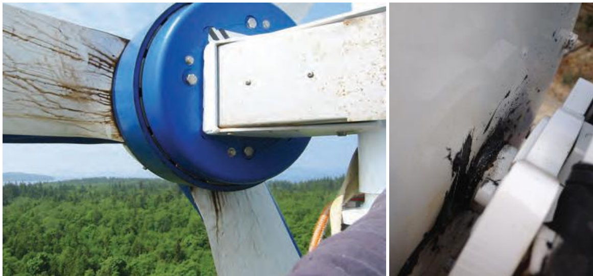
Figure 10 : Signes de roulement en très mauvais état (à gauche trainées de rouille; à droite agglomérat de résidus et de roulement)
