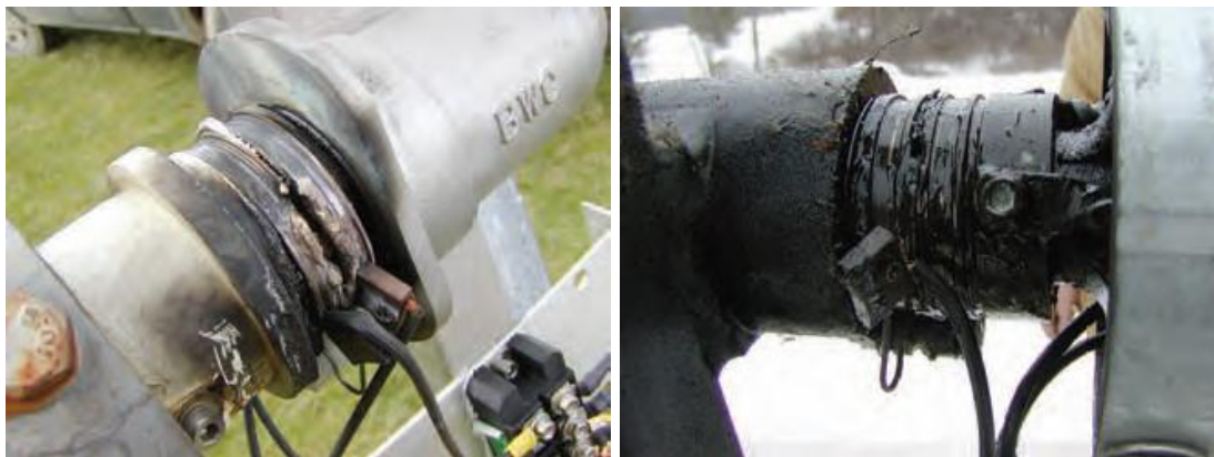
Figure 11 : Collecteurs tournants hors service (à gauche mauvais contact entraînant une surchauffe générale, à droite un collecteur inondé par la graisse d'un roulement défectueux)
